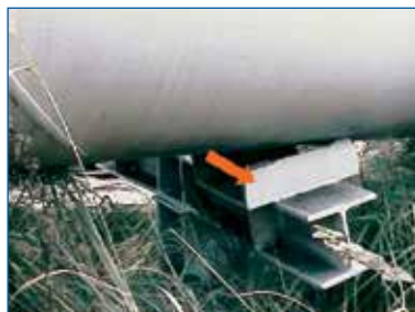
Bild 1-b: Zerstörtes Auflager (Doppel-T-Profil 200 mm bleibend verformt)
