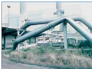
Bild 1-a: Völlig zerstörte Druckrohrleitung DN 600 (Wandstärke 12 mm)
