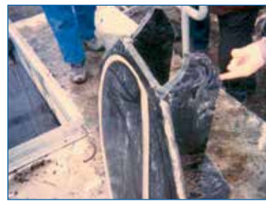
Bild 1-c: Rückflussverhinderer DN 800 nach Druckstoß in der Druckrohrleitung
